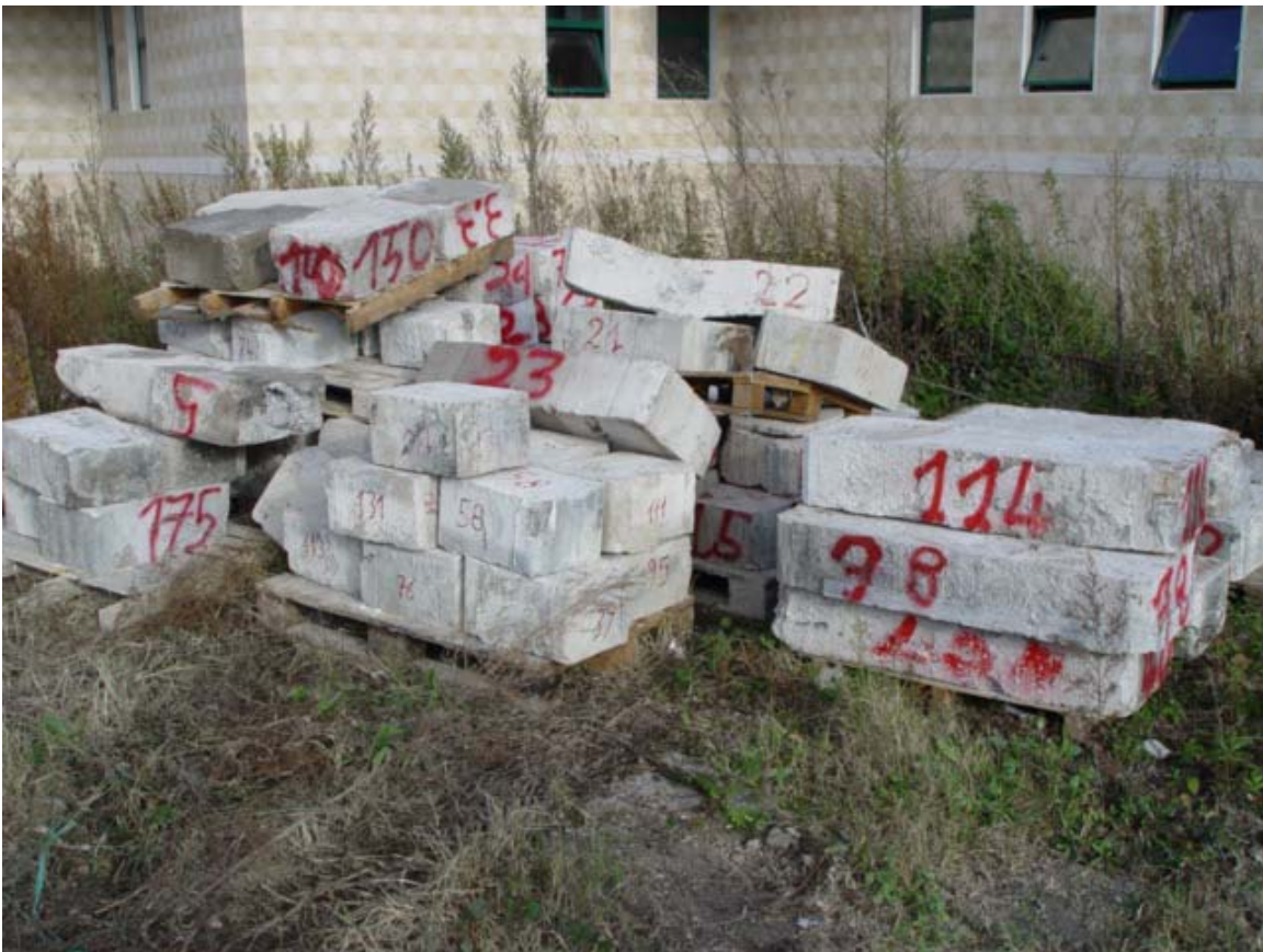
Foto n° 6: Blocchi in c.a. estratti da pilastri e setti nel corso delle procedure di isolamento.
